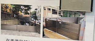
在香港彩虹村火車入口已設置防水閘
